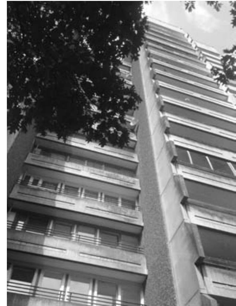
Hochhaussiedlung im Sahlkamp - Der Sanierungsbedarf ist hoch
