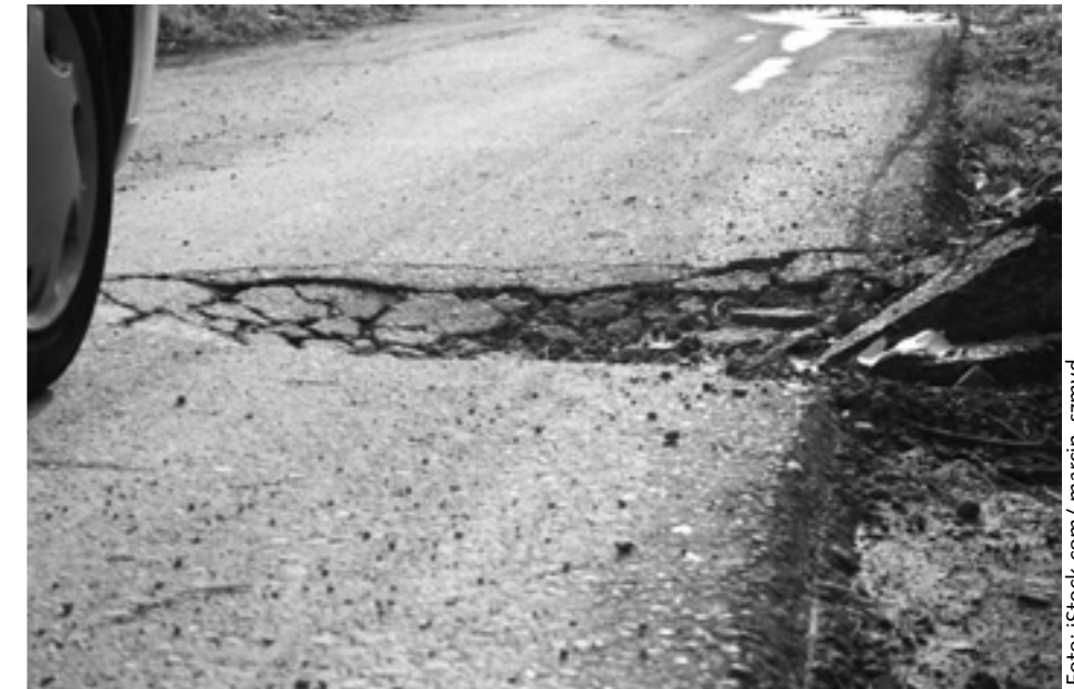
Sanierungsbedürftige Straße - keine Seltenheit in Deutschland.
